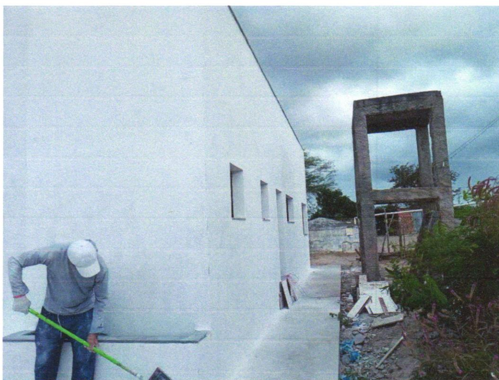
Foto 01 - Chapim de concreto pré-moldado
