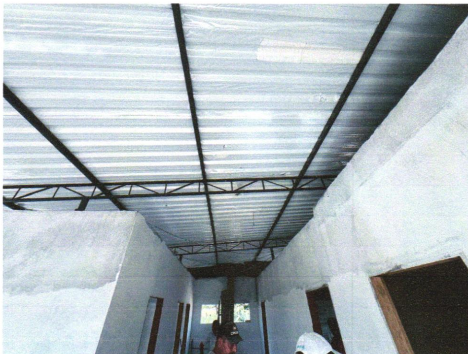
Foto 11 - TRAMA DE AÇO COMPOSTA POR TERÇAS PARA TELHADOS DE ATÉ 2 ÁGUAS PARA TELHA ONDULADA DE FIBROCIMENTO, METÁLICA, PLÁSTICA OU TERMOACÚSTICA, INCLUSO TRANSPORTE VERTICAL. AF_07/2019
